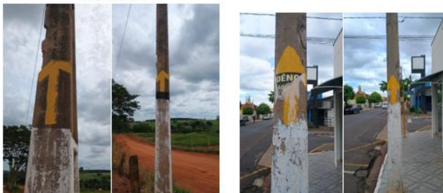
REFORÇO NA SINALIZAÇÃO
